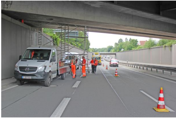
09:30 Uhr – Abschluss der Abdichtkissenmontage im Auflager und Notweg bei Spur 1. Gerüst versetzen nach Spur 2.
