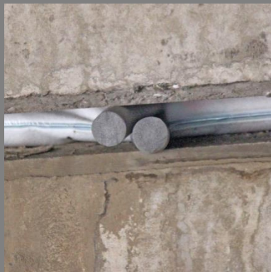
Hilfsmaterial nicht entfernt
