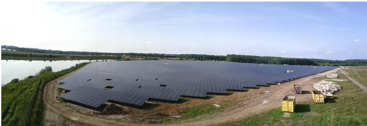
Foto Solarpark Altenburg-Nobitz © Copyright EUROSOL GmbH
